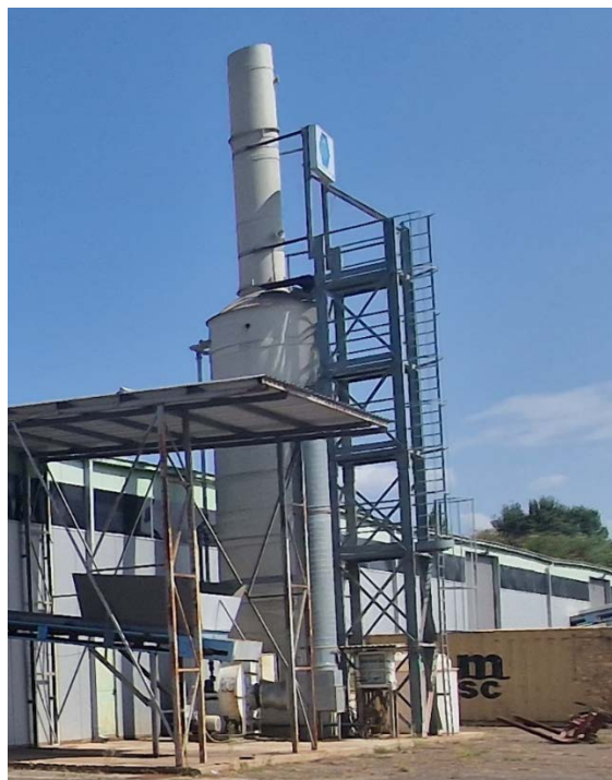
Слика 25 Изглед на скрубер и резервоар за вода
