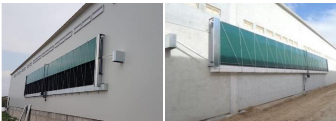
Слика 46 Панели на системот за ладење
