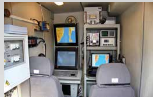
Слика 1: Внатрешноста на контролната кабина во контејнерот
